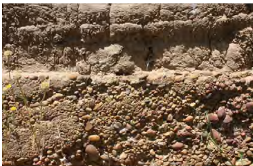
Figura 10. Zócalo de hormigón de la cerca con su acabado exterior erosionado.
