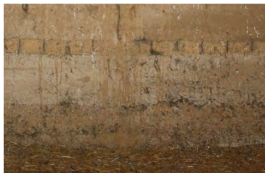
Figura 11. El algunos puntos de la cuadra y pajar, el rebaje hecho en el suelo ha dejado vista la cara interior de la zapata de cimentación. Sobre el murete se aprecia una hilada de adobe que permite la colocación de los medios auxiliares para la ejecución de la tapia.
