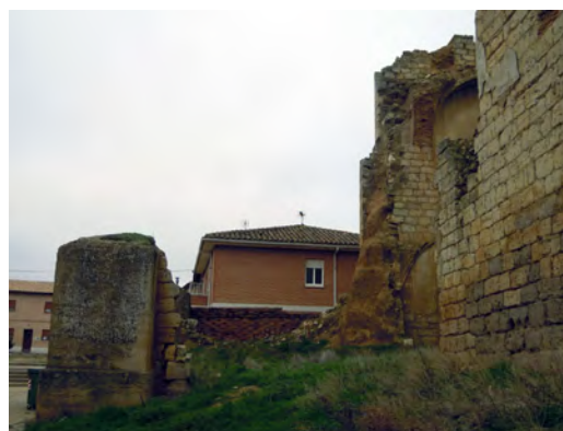
Figura 3 Estado actual de la torre. Imagen tomada por los autores.
