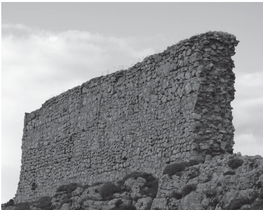
Figura 3. Tramo septentrional de la muralla de la ciudad fortificada de Peñalcázar (fotografías de Ignacio Javier Gil Crespo).
