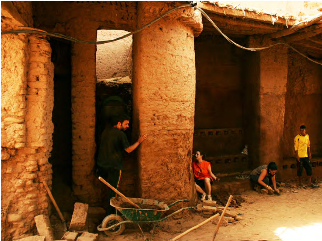
Figura 5. Imagen de los trabajos en la puerta oeste de M'Hamid El Ghizlane. Fuente: Asociación Terrachidia.
