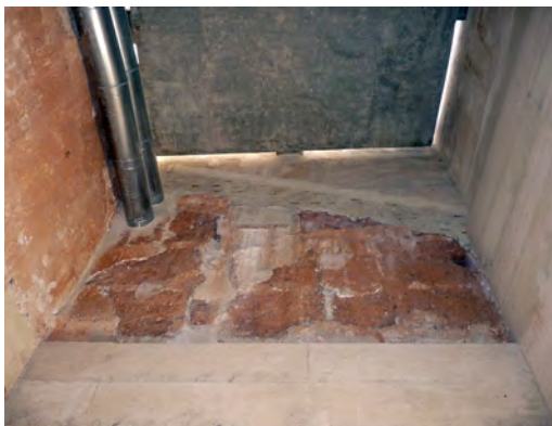
Figura 9. Conductos de aire acondicionado atravesando un muro de tapia de la torre. Castillo de Ribarroja. Fuente: autores.
