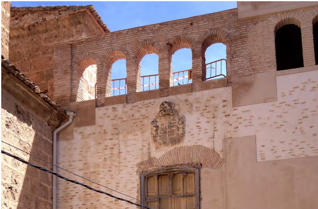
Figura 5. Muro revestido intentando imitar la tapia valenciana. Palacio de los Milán de Aragón. Albaida. Fuente: autores. Fuente: autores.
