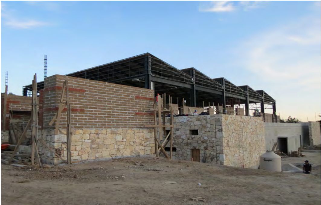
Figura 3. Proceso de construcción de un moderno conjunto deportivo diseñado bajo criterios estructurales tradicionales, y edificado a partir del manejo de materiales elaborados artesanalmente, Oaxaca. Fuente: João Boto Caeiro.
