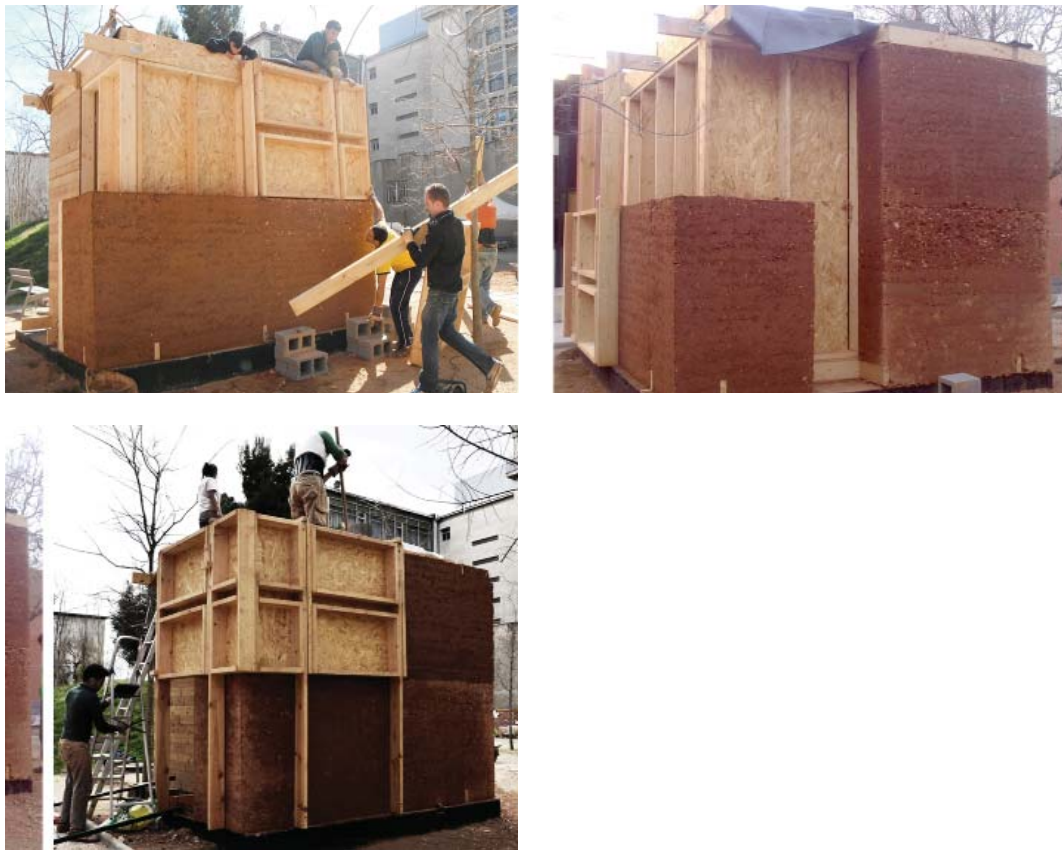
Figura 4. Vistas del montaje del prototipo S-low en la UPC. Encofrato exterior y muros de tapial. Casa S-low.
