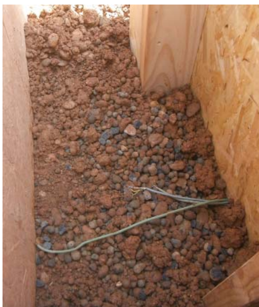
Figura 5. Cableado en el interior del elemento de cerramiento para la instrumentación y recogida de datos térmicos. Fuente: Allepuz, Poza
