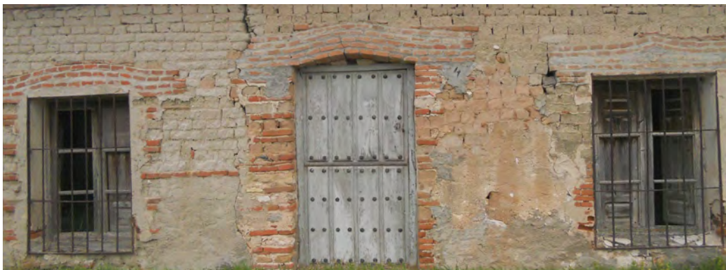
Figura 2. Detalle de una vivienda abandonada en Laguna Rodrigo (Segovia). Fuente: Enrique Sevillano Gutiérrez 2012.
