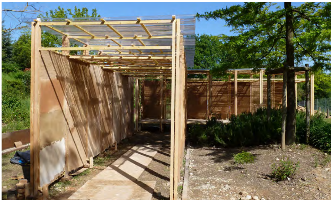
Figura 5. Pabellón para la experimentación de revocos de tierra y de técnicas de relleno con tierra construido por los estudiantes del DSA-Terre durante el festival “Grains d’Isère” 2013. Fuente: Anaïs Chesneau 2013.
