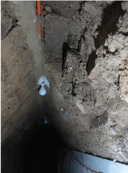
Figura 6. El uso de juntas de considerable grosor pudiera estar asociado a los desprendimientos que tienen lugar en los túneles realizados para la exploración del Edificio 3. Fuente: Marisol Aguirre.
