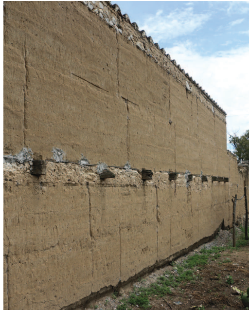
Figura 1. Muro tradicional de tapia de tierra en San Andrés Payuca, Puebla, México. Fuente: Acervo del Laboratorio de procedimientos y sistemas constructivos tradicionales como alternativa para una arquitectura sustentable, FA/UNAM (LABPySC)
