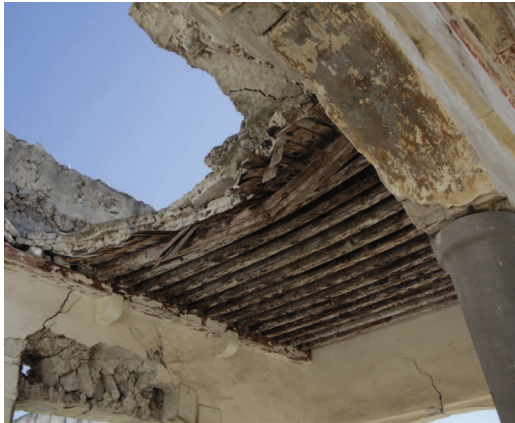
Figura 3. Techo de vigería y entortado de cal y piedra pómez en la Hacienda Pizarro, Puebla. Fuente: Acervo del LABPySC FA/UNAM.
