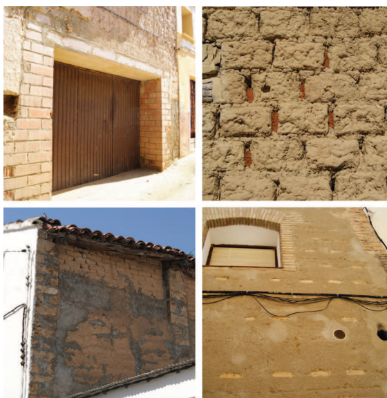
Figuras 5, 6, 7 y 8. (de izquierda a derecha y de arriba abajo) 5- Apertura de un nuevo hueco en un muro de tapia y adobe. Alcolea del Cinca (Huesca), 22 mayo 2017. 6- Relleno de las juntas de adobe con espuma de poliuretano expandido. Perarrúa (Huesca), 30 Octubre 2016. 7- Relleno de oquedades en un muro mixto de adobe y pilares de piedra. Ontiñena (Huesca), 22 mayo 2017. 8- Revestimiento de cemento en un muro de tapia suplementada con ladrillos en los paramentos. Villanueva de Sigena (Huesca), 22 mayo 2017. Fuente: L. Villacampa Crespo.
