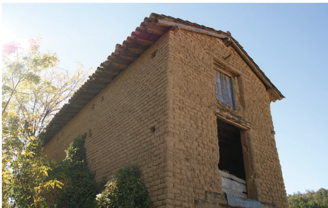
Figura 3. Construcción de fábrica de adobe simple. Graus (Huesca), 30 octubre 2016. Fuente: L. Villacampa.
