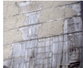
Figura 12. Pared de caña guadúa que demanda reparar el "enquinchado"
