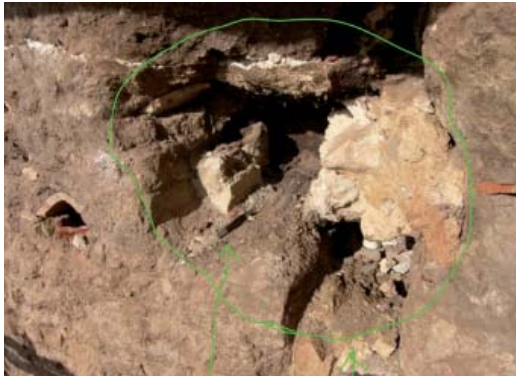
Figura 1. Gran hueco, con pérdida de material, en el muro sur. Se aprecia la junta de cal entre las dos hiladas del tapial y algunos agujales o pasa-agujas conformados mediante doble teja. (Foto: los autores).
