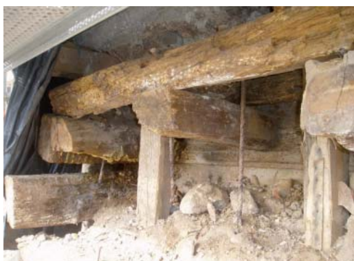
Figura 3. Gran hueco, con pérdida de material, en el muro sur. Se aprecia la junta de cal entre las dos hiladas del tapial y algunos agujales o pasa-agujas conformados mediante doble teja. (Foto: los autores).
