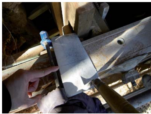
Figura 13. Marca en la paleta que permite controlar el espesor de vertido de cada tongada de tierra, de unos 15 cm de espesor. (Foto: los autores).
