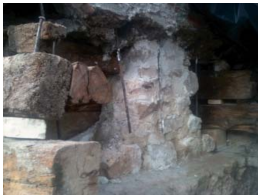
Figura 12. Tapón ejecutado en la coronación del muro, en la zona en que el hueco lo atraviesa por completo. Al fondo se observan las tablas del alicer del artesanado mudéjar. (Foto: los autores).
