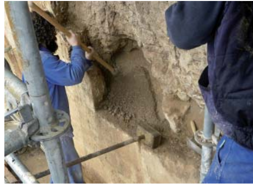
Figura 10. Proceso de apisonado, mediante pisón circular de pequeño diámetro, con un ángulo de ataque de 45°. (Foto: los autores).
