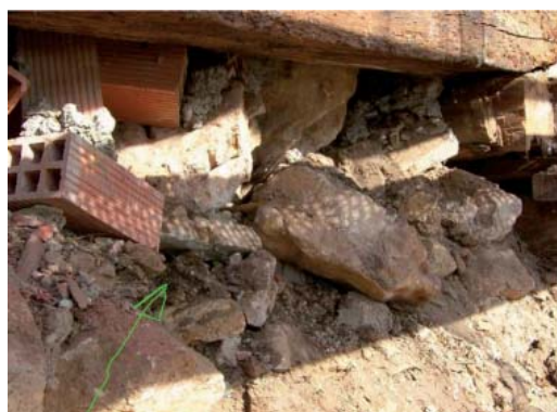
Figura 4. Relleno confuso y desconcertado de mampuestos de piedra y ladrillo hueco doble. (Foto: los autores).
