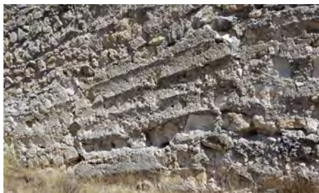
Figura 14. Lienzo donde se aprecian las marcas de las tablas del encofrado. Autora: Alicia Sainz Esteban.
