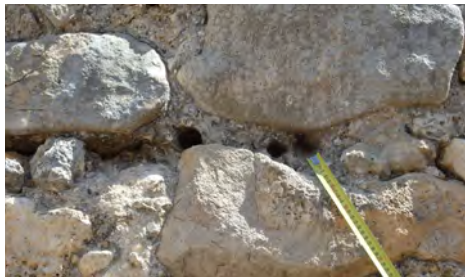
Figura 18. Detalle que muestra el sistema constructivo empleado, varillas pareadas en lugar de agujas de madera. Autora: Alicia Sainz Esteban.
